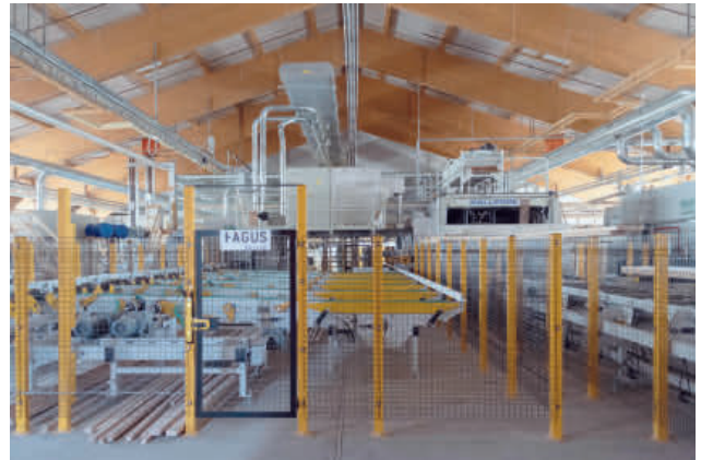
Werkhalle der Fagus mit neu aufgebauten Produktionsanlagen
