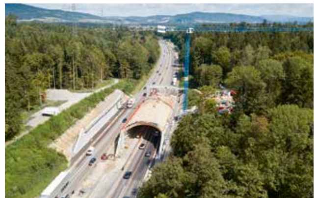
Montage des Holztragwerks bei fließendem Verkehr: in einer ersten Etappe das Portal über die Fahrbahn Richtung Zürich, in einer zweiten über die Fahrbahn Richtung Bern.
