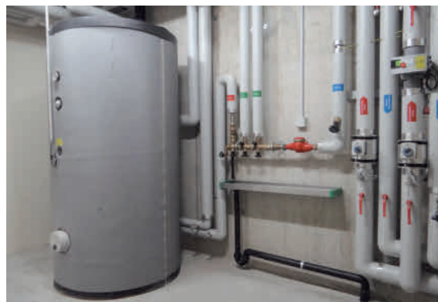
Wohlen AG, Überbauung Steindler: Wärmeübergabestation für ein Mehrfamilienhaus. Quelle: Holzenergie Schweiz, Christoph Rutschmann
