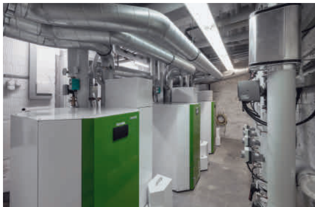
Kompakt und sauber: Heizzentrale für die katholische Kirche und das Pfarreizentrum Lenzburg. Quelle: Braunschweiler Pellets AG
