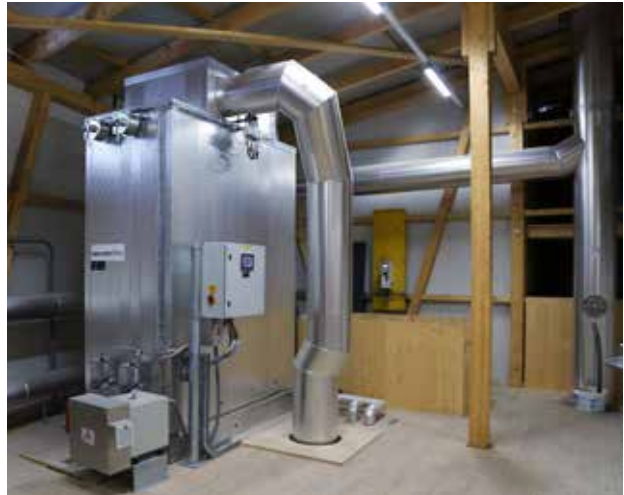
Sorgt für saubere Luft: elektrostatischer Feinstaubabscheider
