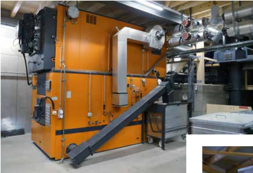
◀ Herzstück des Wärmeverbundes Murgtal: der Kessel mit 700 Kilowatt Leistung
