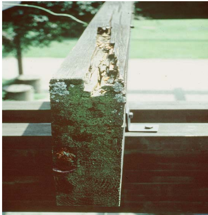
Abbildung 4: Horizontale und grossquerschnittige, ungeschützt bewitterte Balkenteile aus Brettschichtholz mit Fäulnisschaden, ausgehend von frei exponierter Hirnholzpartie und tiefen Rissen auf der (zu) scharf beanspruchten Oberfläche.
