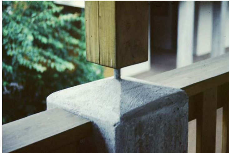
Abbildung 3: Beispiel für ein gutes Konstruktionsdetail: Der Stützenfuss ist perfekt gegen aufsteigende Feuchte und Spritzwasser geschützt.
