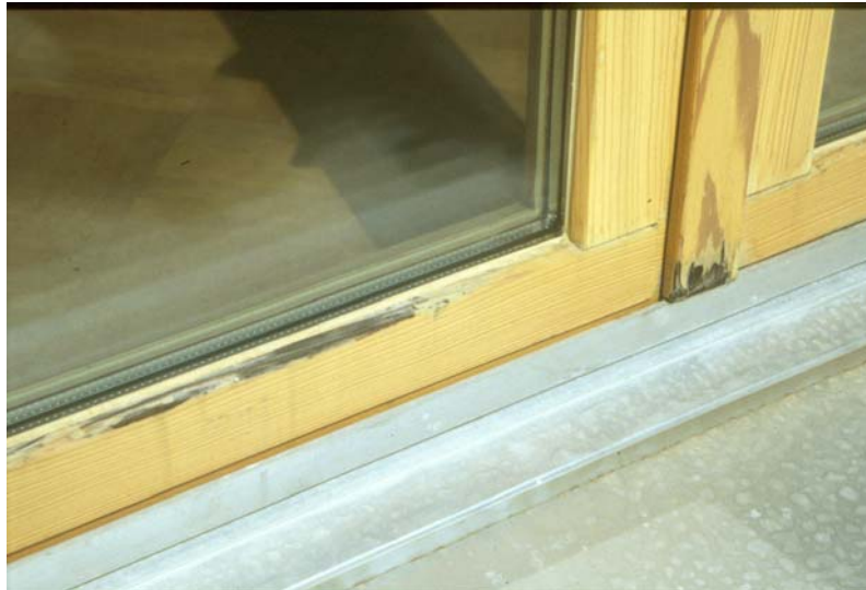
Bild 5: Lärchenholzfenster mit kaum pigmentiertem Lasuranstrich. Die Oberflächenbehandlung ist schon nach 2 Jahren auf den Schmalflächen des unteren Flügelrahmenprofils und bei unteren Hirnholzpartien verwittert; das Holz ist dort von Vergrauungspilzen befallen. Transparente Behandlungen sind für wetterbeanspruchtes Holz ungeeignet.
